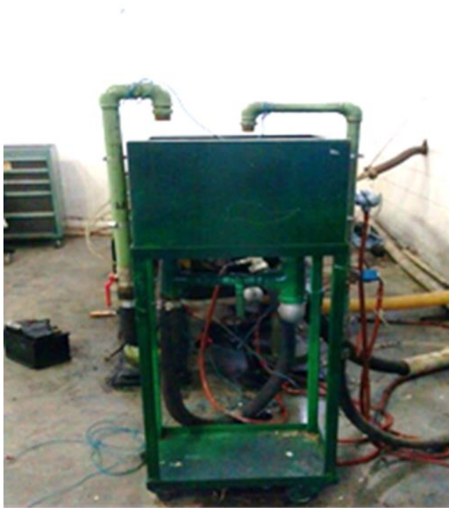
Şekil 3.5. BT 190 hidrolik dinamometre kullanılan soğutma kulesi
