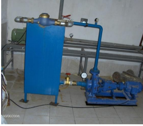
Şekil 1. Denemede kullanılan pompa sistemi Figure 1. Pump system used at the experiment
