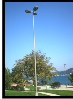
Şekil 15. Topuzlu Park aydınlatma elemanı Figure 15. Topuzlu Park lighting elements
