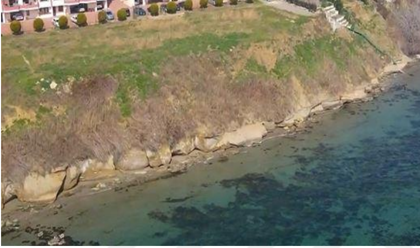
Şekil 4.48. Hürriyet Mahallesi sahil şeridi mevcut durumunda geçişe izin vermeyen denize sıfır alan
