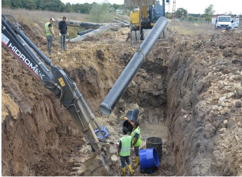
Şekil 4.14. Kazı alanına emniyet tedbiri almadan içme suyu borusu indirilmesi
