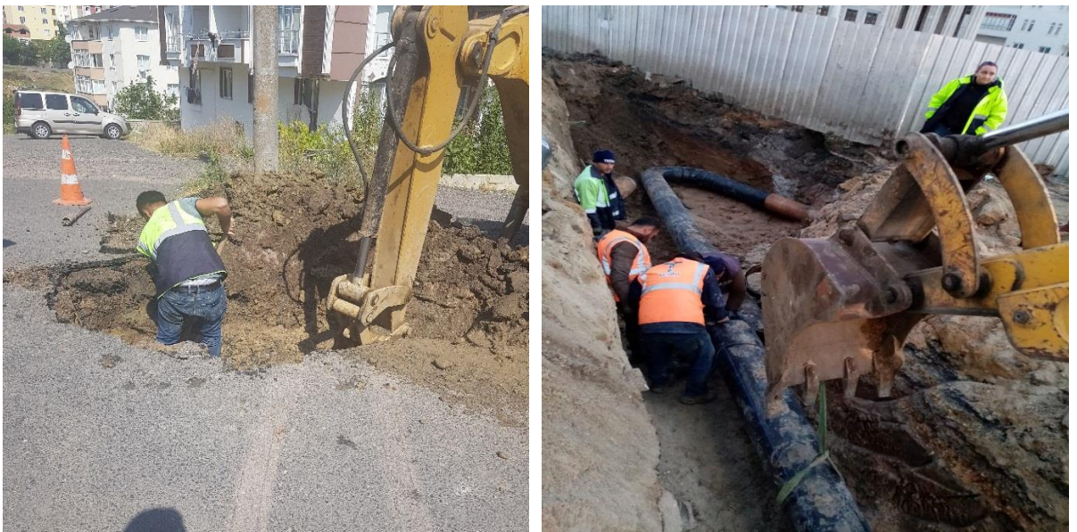
Şekil 4.10. İş makinelerinin manevra alanında emniyetsiz çalışma
