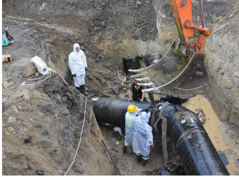
Şekil 4.12. Ana isale hattı kazılarında iksa ve şevli kazı yönteminin kullanılmaması
