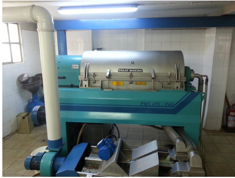
Şekil 4.5. Zeytin Dekantör (Susuzlaştırma) Ünitesi (orijinal)
